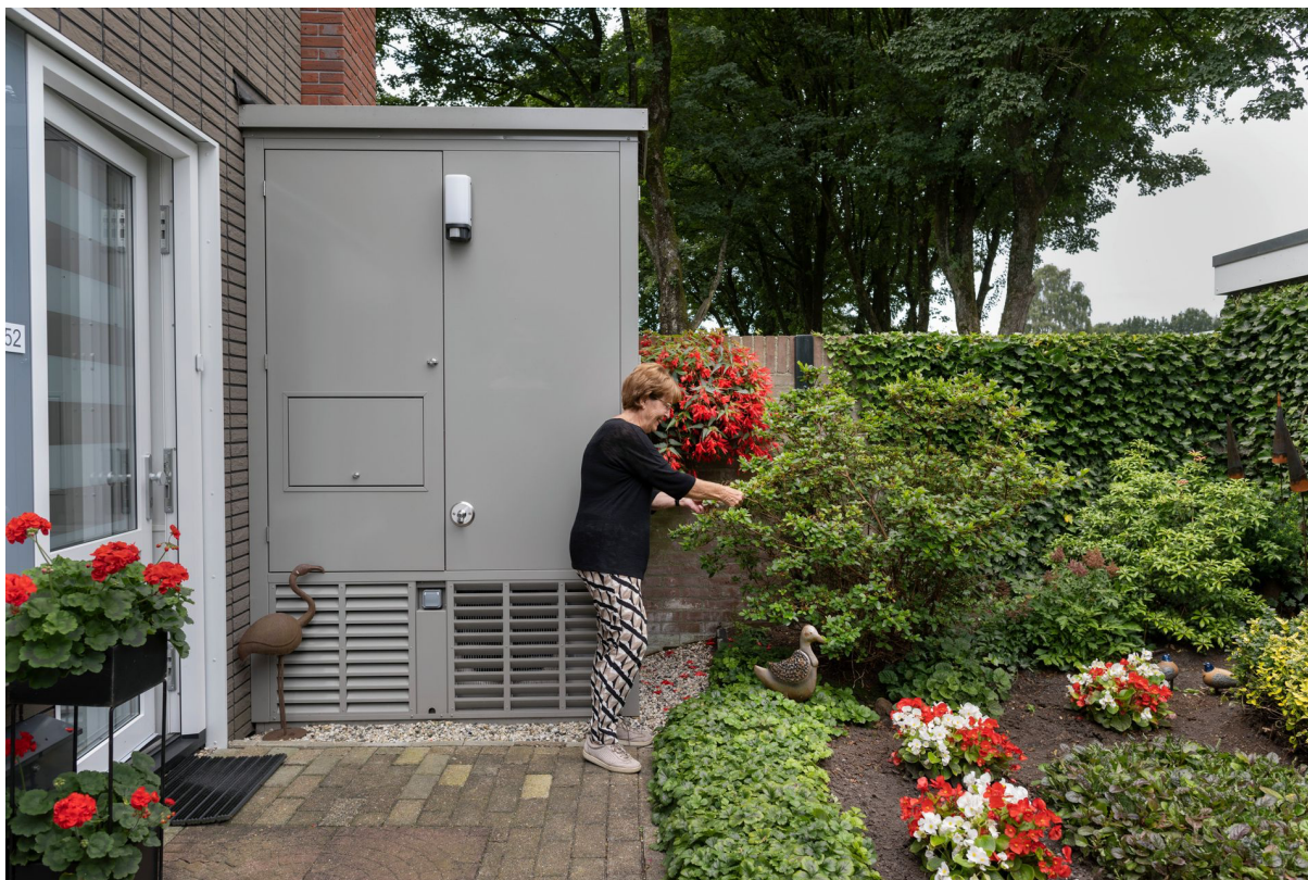
Een aangepaste woning in Emmerhout met in de kast de warmtepomp. Foto Sake Elzinga
